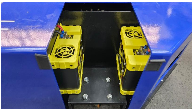
Figura 11: Compartimento interno mostrando os carregadores (componentes amarelos) para monitoramento da carga
